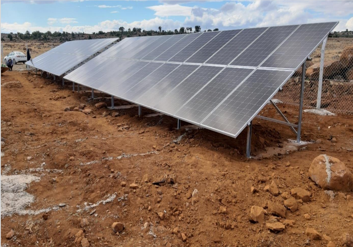
Hasancalı Köyü Güneş Enerji Santrali
