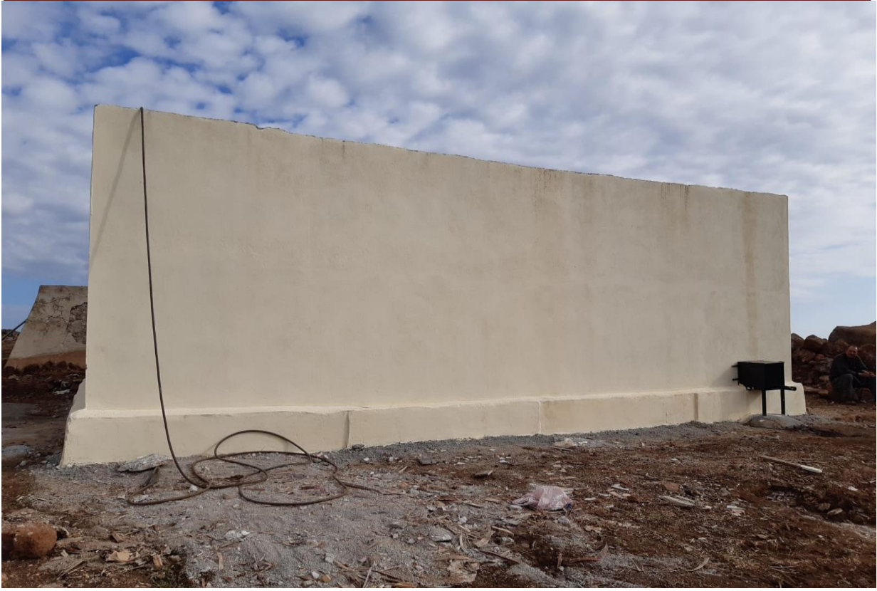
Hasancalı Köyü 200 Tonluk İçmesuyu Deposu
